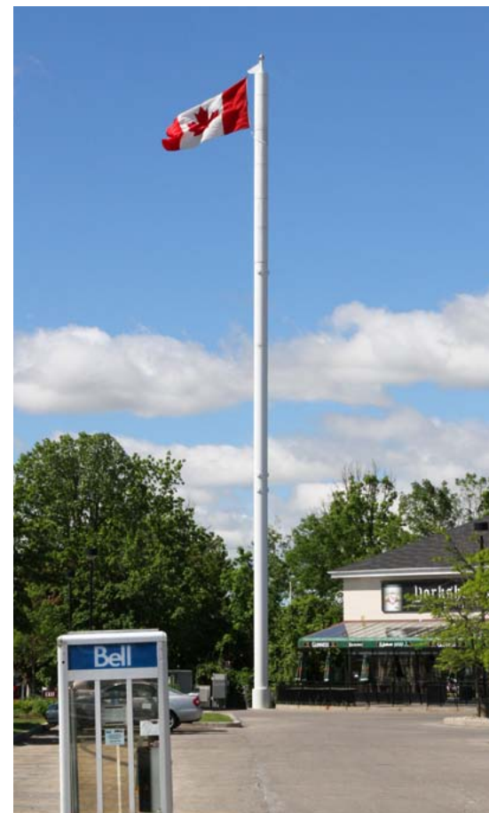
Antenne de Bell Mobilité à l'intérieur d'un mât de drapeau
