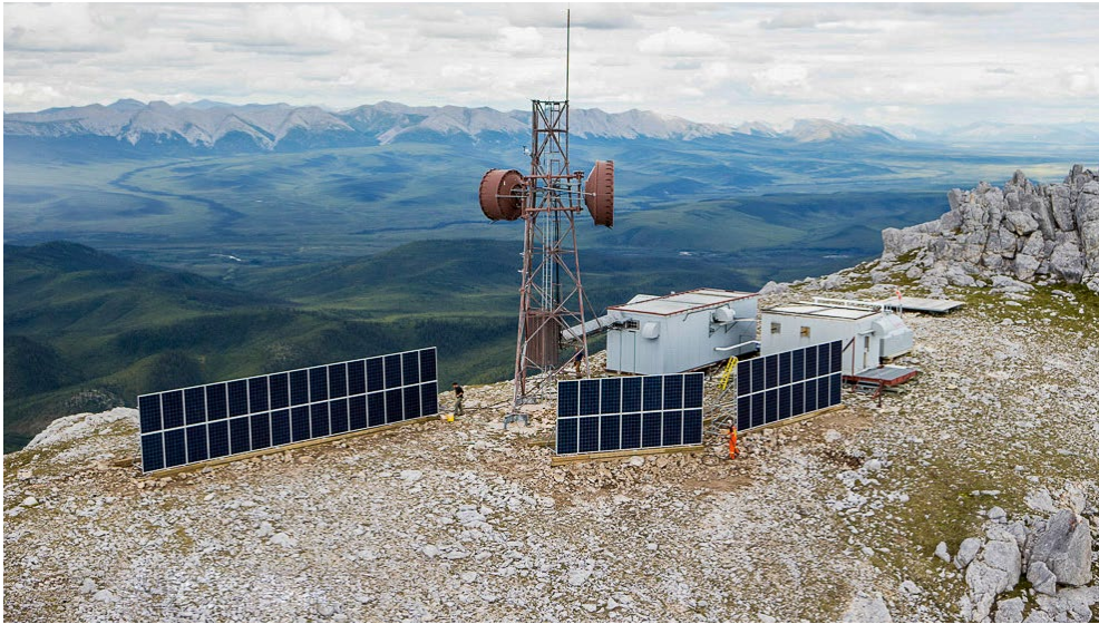
À la suite d'essais fructueux en 2013, nous avons installé en 2014 quatre ensembles de panneaux photovoltaïques de 15 kW dans des sites accessibles par hélicoptère à Courageous Lake, MacKay Lake, McEvoy Lake et Weasel Lake.
