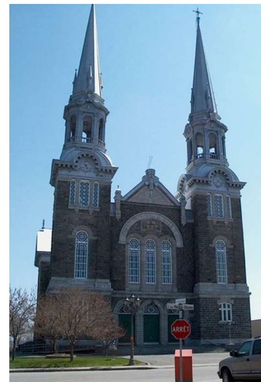
Des antennes sont dissimulées dans un clocher de l'église Notre-Dame, sur la rue Notre-Dame, à L'Ancienne-Lorette (Québec). La flèche a été modifiée afin d'installer deux antennes dirigées dans deux directions.
